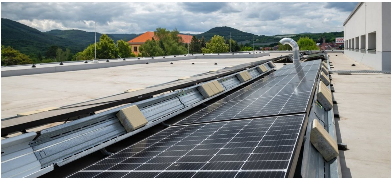
Střešní fotovoltaická elektrárna
