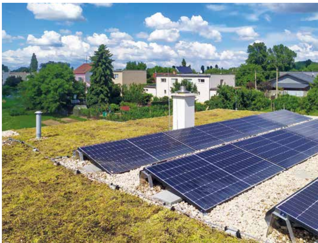
Střecha rozdělená na fotovoltaickou část a zelenou střechu. Foto: Pavel Dostal
