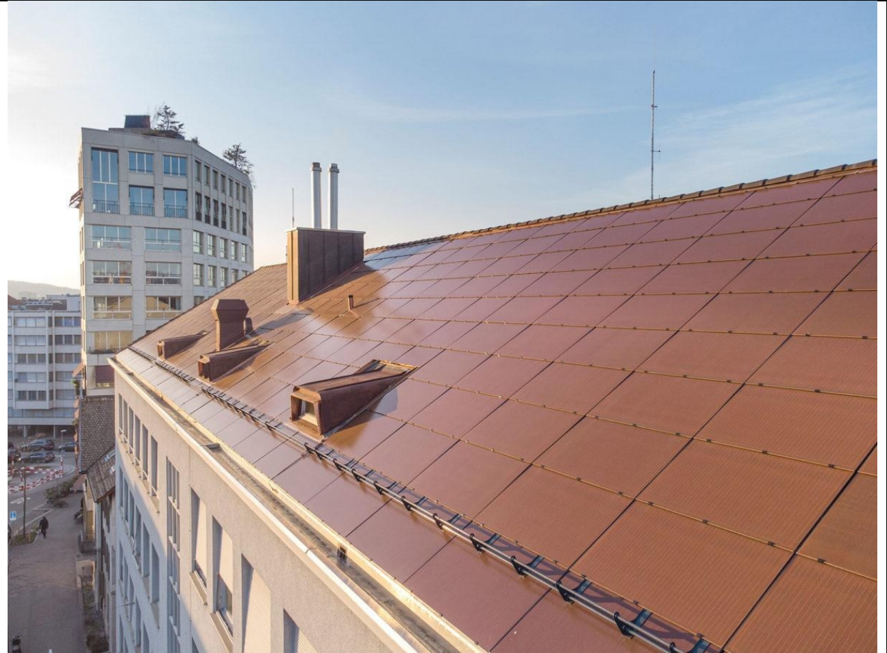
Ukázka realizace střešní fotovoltaické elektrárny (základna hasičů, Švýcarsko)
