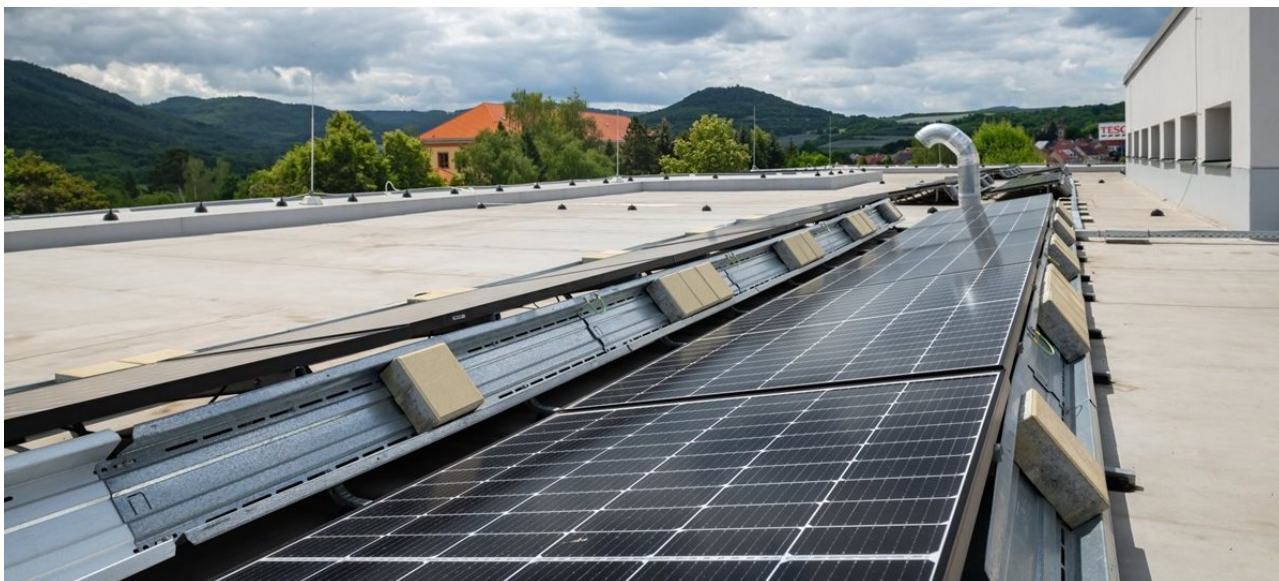
Střešní fotovoltaická elektrárna
