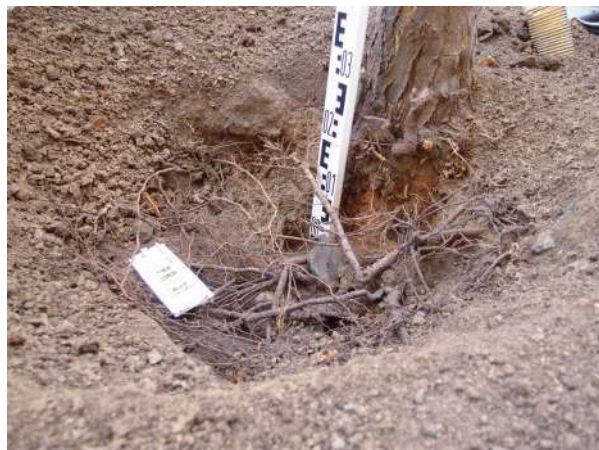
Obr. 18 Kořenový krček se nachází minimálně 15 cm pod úrovní obalu zemního balu. Tato „skrytá“ vada způsobila časovou ztrátu nefunkčních výsadeb od r. 2004, které mohly plnit ekosystémové služby jako 15leté stromy
