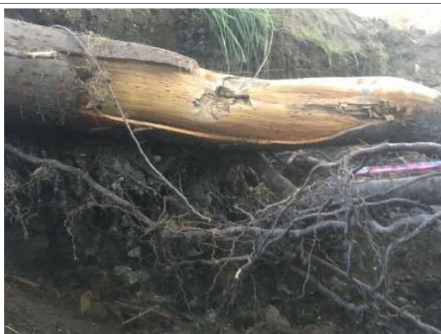
Obr. 20 Poškození kořenů při stavebních pracích
